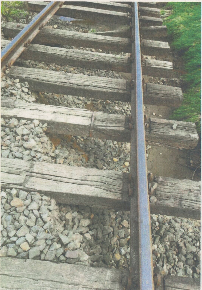
Das Wasser hat die schwere Schicht aus Schotter unter den Schienen mit sich gerissen.
