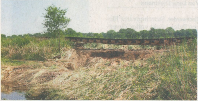
Der Bahndamm in der Havighorster Feldmark ist weggespült worden. Auf knapp 20 Metern liegen die Gleise frei.
