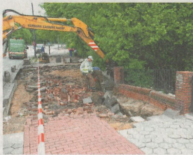
Weggespülter Fußweg an der Habermannstraße in Lohbrügge.
